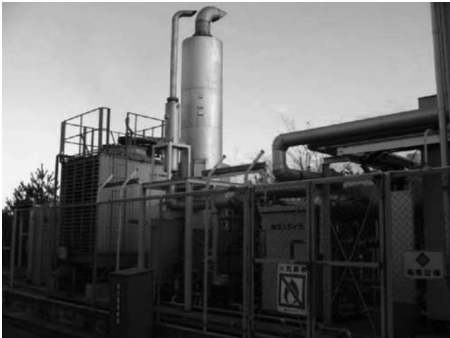
写真—3 排ガスボイラ・冷却塔等付帯設備
