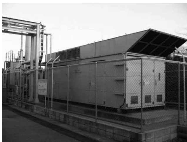
写真-2 バイオガス式ガスエンジンユニット外観（エンクロージャ収納）
