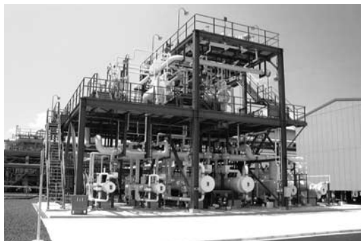
写真-1 BOG処理設備の全景
