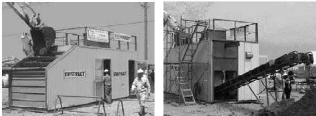
写真-2 粒状固化処理装置（標準ユニット型）
