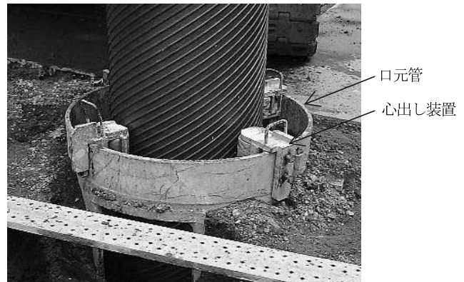
写真—2 心出し装置
