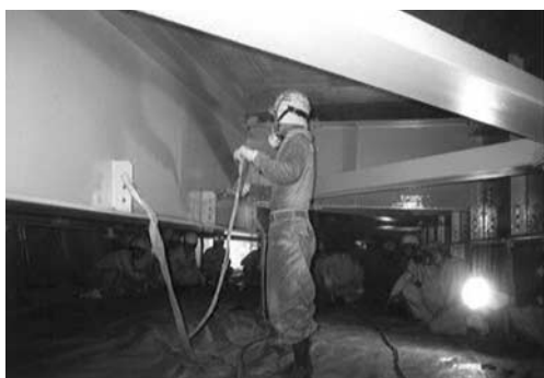
写真—1 高塗着スプレー塗装作業の様子 7) (塗料のはね返りやミストの浮遊はほとんど認められない)
