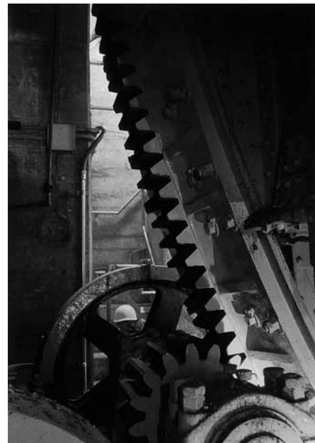
写真一 橋脚内のギア 小さなギアの回転を巨大なギアへ伝え、橋桁をあげる。
