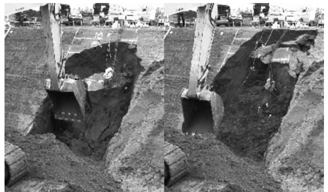
(b) 2回目崩壊 (連続的に法肩まで崩壊)
