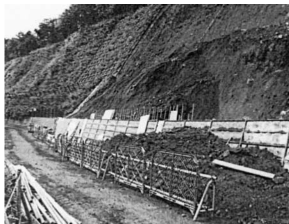
写真一 1 型枠の解体中に斜面が崩壊した労働災害事例
