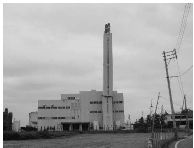
写真一七 折損したごみ焼却場の煙突 (柏崎市提供)
