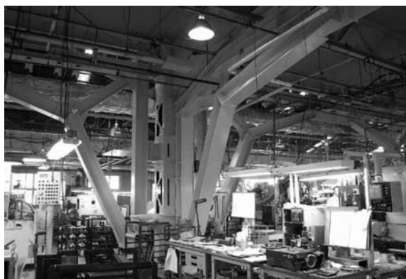
写真—2 耐震補強されていた工場（㈱リケン提供）
