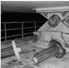
写真三 支承ピン脱落 (青海川橋下り線)
