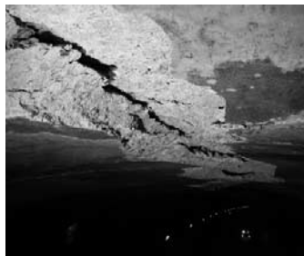
写真四 頂版のはく落 (米山トンネル上り線)
