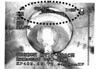
写真-9 横断排水管のわれ
