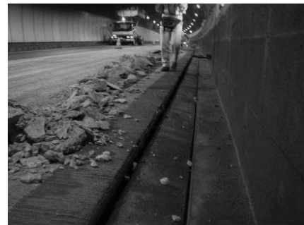
写真-16 覆工コンクリートはく落状況
