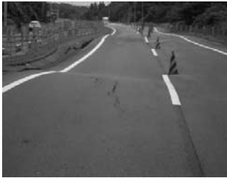
写真一 路面の波打ち (北陸道下り線 408.4KP)
