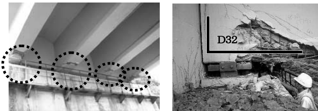
写真-10 損傷状況
