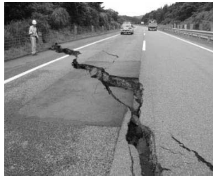
写真二 路面の段差 (上り線 409.7KP)
