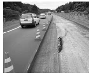
写真-8 舗装路盤の空洞・亀裂
