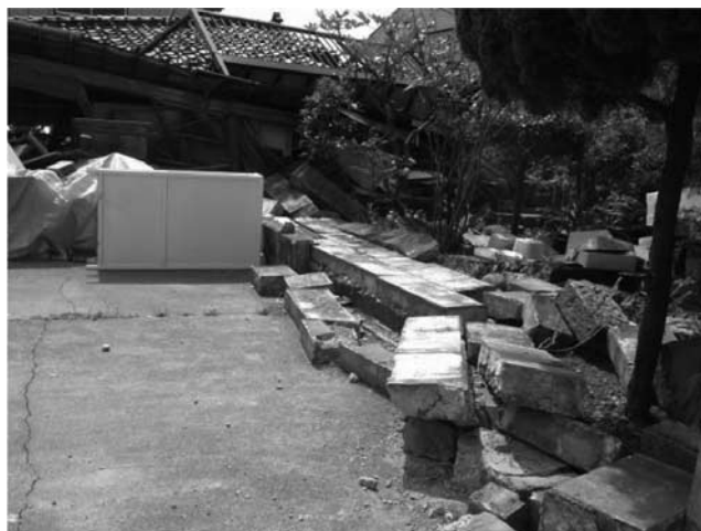
写真—7 倒壊した石積みの塀
