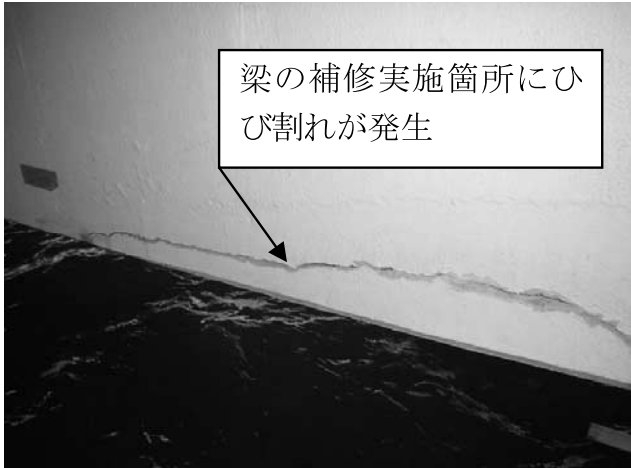
写真一七 断面修復箇所の劣化事例
