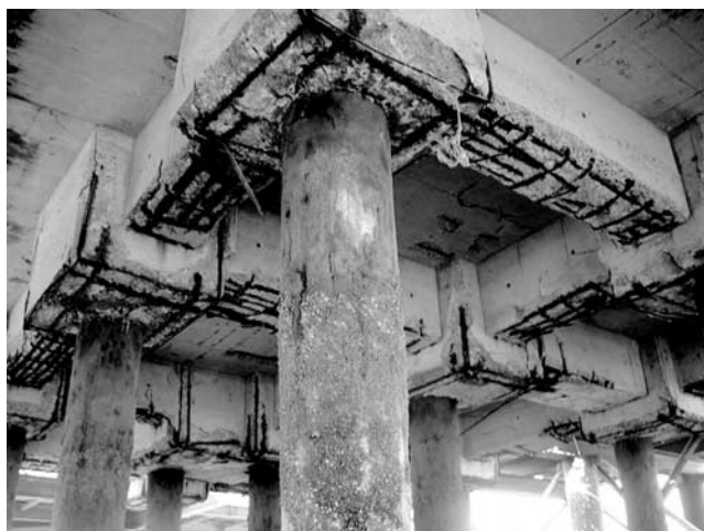
写真—1 棧橋の劣化事例
