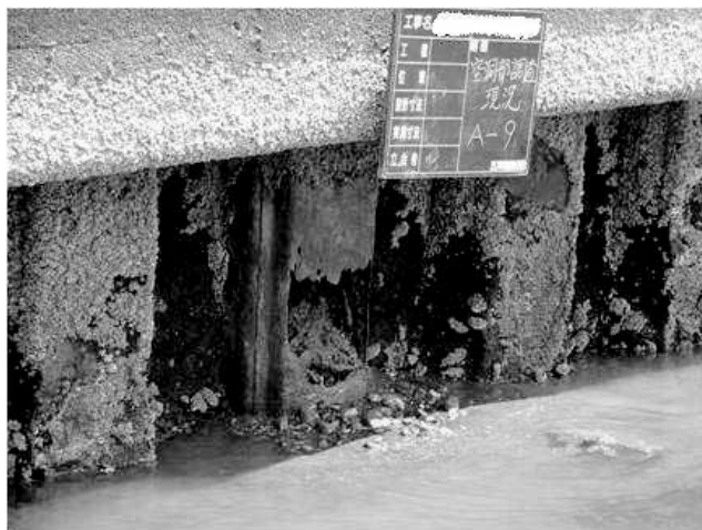
写真—2 鋼矢板の劣化事例
