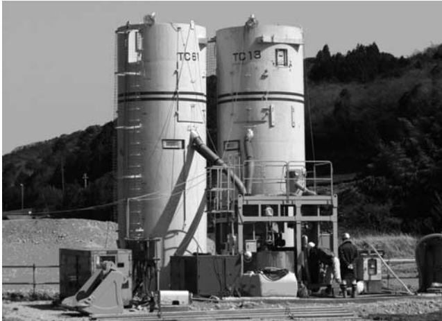
写真—1 固化材のスラリープラント
