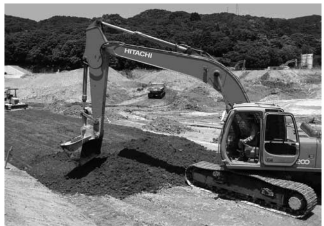
写真—4 解砕土層均一化のためのバックホウによる撒出し
