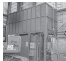
写真-1 エコグラウトプラント
