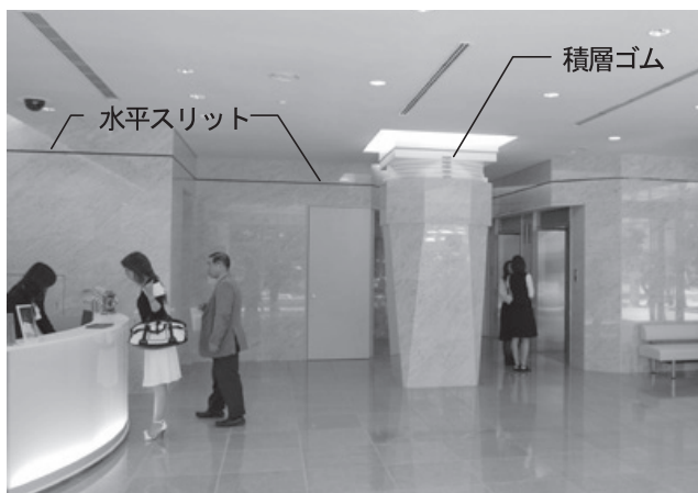
写真一3 積層ゴムが設置された柱
