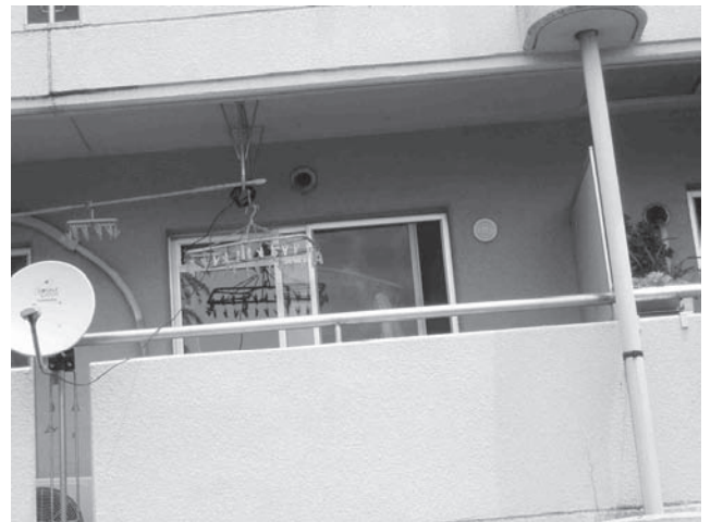
写真一3 可視写真 (吹付けタイル)
