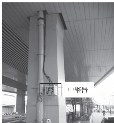
図一九 橋脚基部における中継機の設置状況
