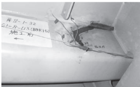
(a) き裂進展状況 (L=902 mm)
