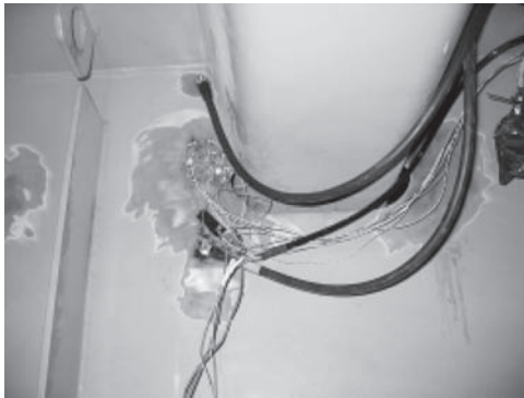
図一七 スカラップき裂発生部計測状況
