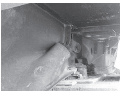
写真-2 上層主桁変形損傷状況
