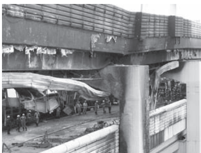
写真-1 火災事故の状況
