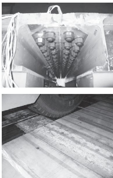
写真-2 ユニットのボルト添接部
