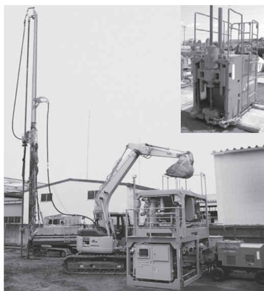
写真二 システム全景
