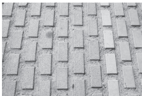
写真—1 植生が衰退した緑化ブロック舗装の例
