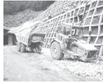
写真一 2 ダンプトラックでの事故発生状況
