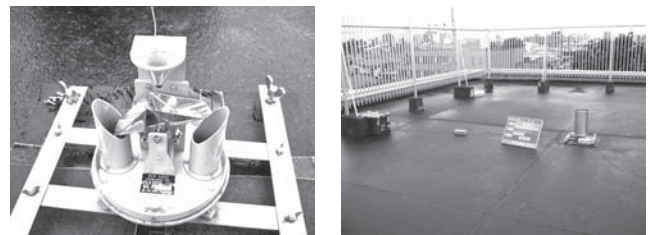
写真一2 転倒ます型雨量計(左)と設置状況(右)
