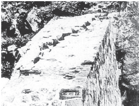
写真—1 甚之助谷5号えん堤左岸袖部の亀裂（昭和3年10月）
