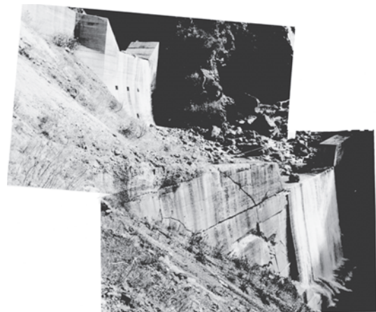
写真—2 柳谷第3号砂防えん堤の右岸袖部の亀裂（昭和54年）
