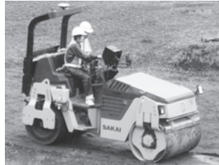
締固め管理システム
