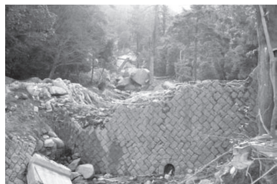
写真3 被災状況 (大聖院上部)
