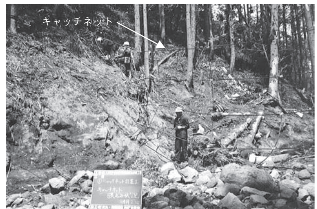
図-3 キャッチネットの設置状況
