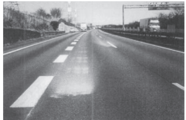
写真-2 内部損傷の例（ボンピング）
