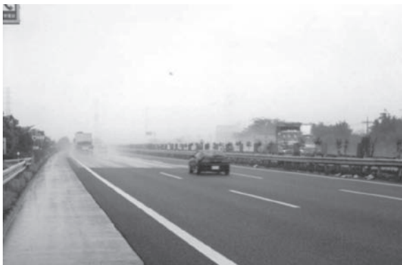
写真-1 雨天時の高機能舗装
