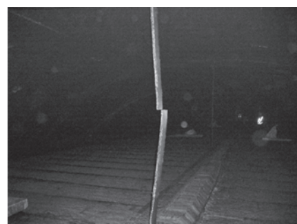
図一7 既設吊金具状況（通常部・損傷部）
