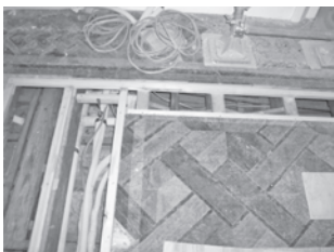
設備床下配管部
