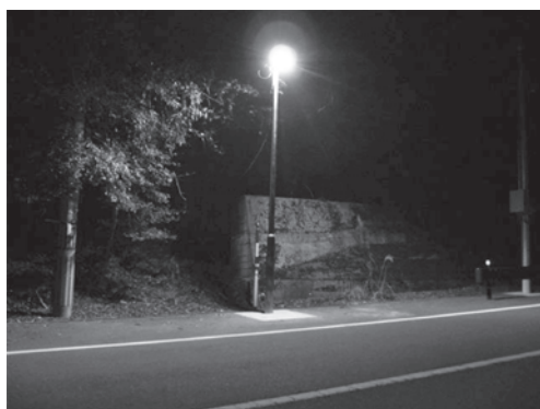
図一六 LED 歩道照明の設置事例
