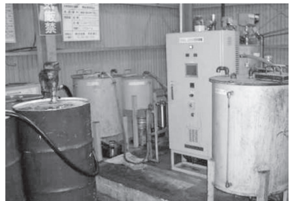
写真一3 BDF精製プラント 外観
