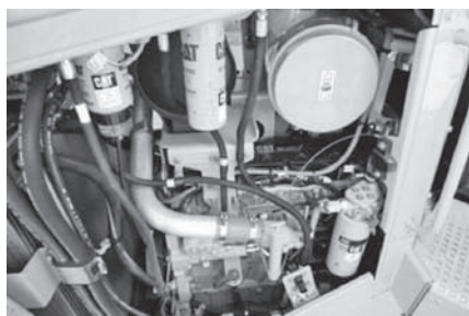
写真-12 エンジン左側サービスドア内部
