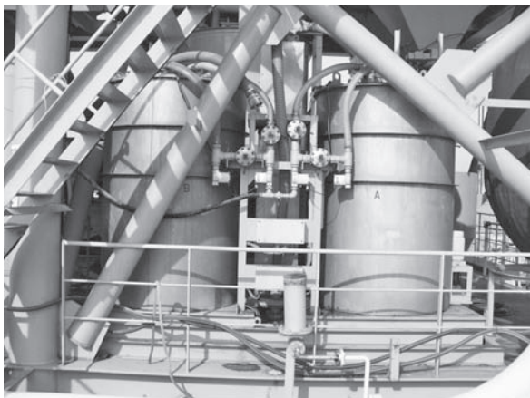
写真—9 気泡製造設備（計量器）
