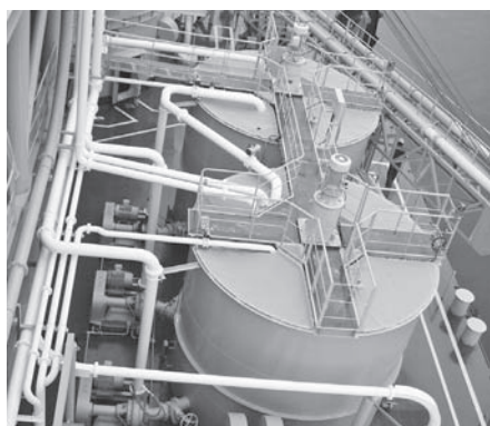
写真一 2 調泥槽
