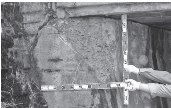
写真三 凍害を受け、桁かかり部分に剥落が生じた橋台
