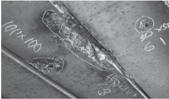
写真一 防水工不良による漏水から剥離鉄筋露出にいたったPC桁
