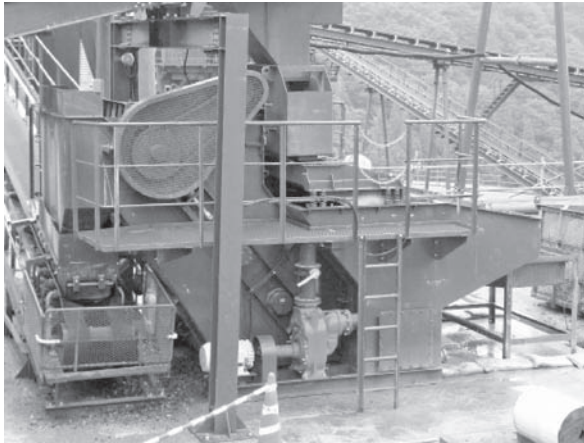
写真一4 バケット式ゴミ取り機
