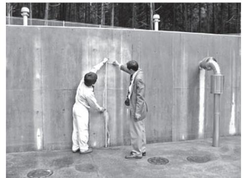
写真一4 練炭とジェットヒーターによって養生された貯水槽でひび割れ調査
