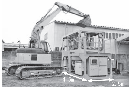
写真—2 流動化砂製造プラント
