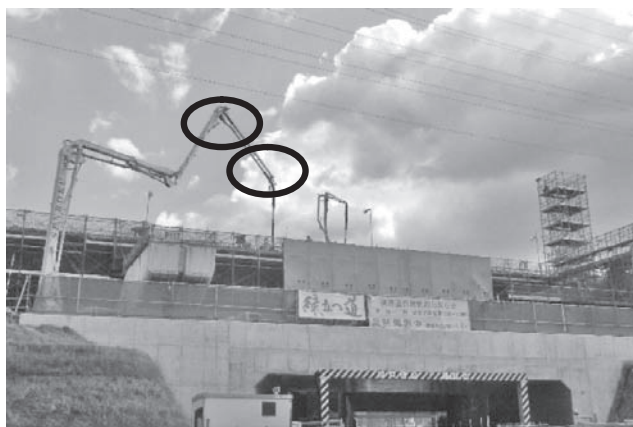
写真一6 球面リフレクタ取付けポンプ車による施工状況
