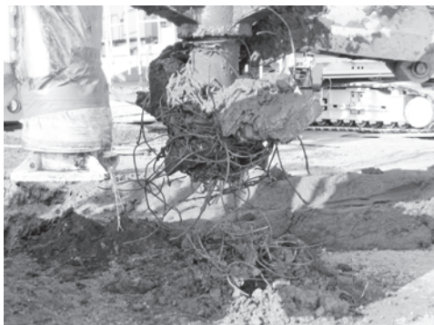
写真一6 複合相対攪拌翼によって破断した PC 鋼線
