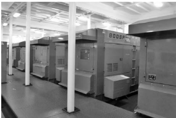
写真一2 可搬式発電機
