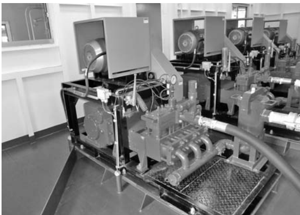
写真一五 グラウトポンプ
