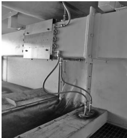
写真一 9 コージェネレーション
