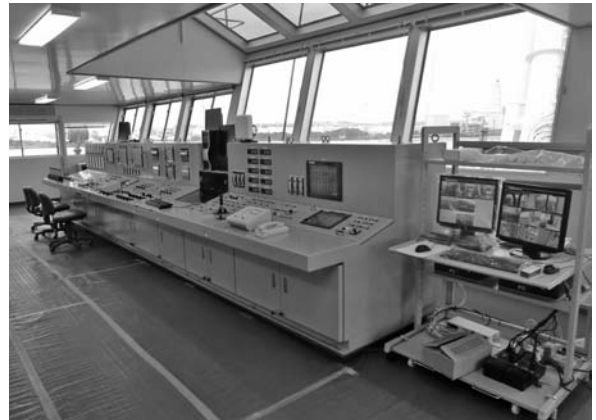
写真一六 操作盤
