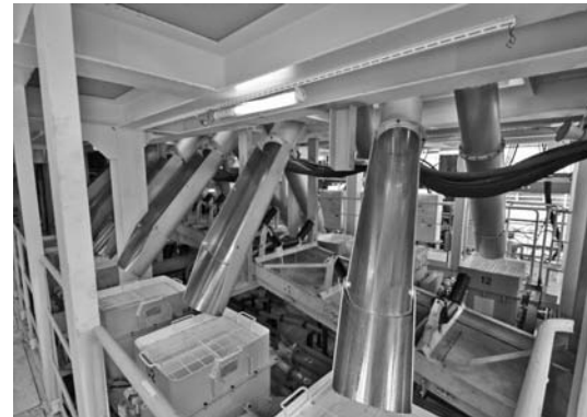
写真-1 コンクリートポンプ
