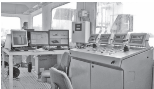
写真—5 昇降・開閉ウインチ操作卓
