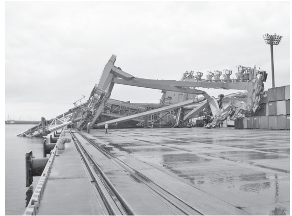
写真一7 コンテナクレーンの逸走事故
