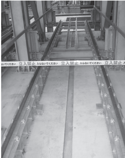
写真-4 ラック内部
