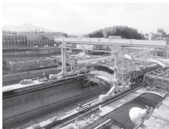
写真-7 橋型クレーン
