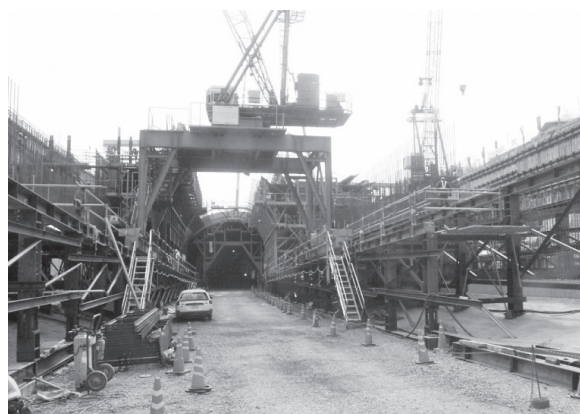
写真-6 ジブクレーン・クレーン台車
