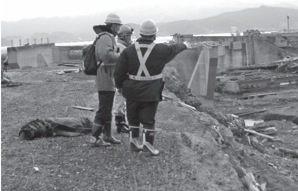
写真一1 東北地方太平洋沖地震での津波による被災橋梁の調査
