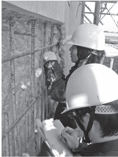
写真—4 塩害橋脚の鋼材腐食状況調査（瀬底大橋）
