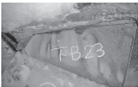
写真二 コンクリート部材の中での局所的な腐食
