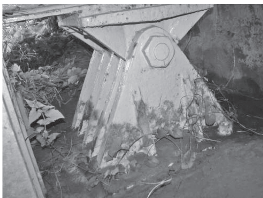
写真一 人が入れない場所での腐食
