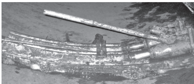
写真一 2 空気漏れを石鹼水気泡で確認
