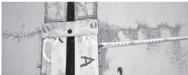
写真一 3 乾燥したコンクリート管の水リーク
