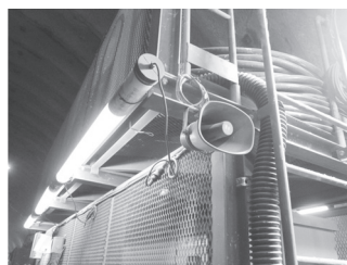
写真—15 坑内スピーカー
