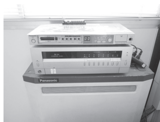
写真—14 坑内放送設備
