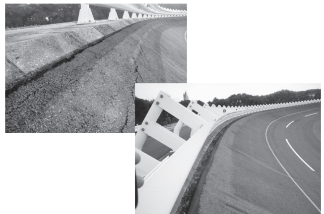
写真一1 バンク上端部損傷
