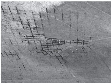
写真—1 RC ドーム内面の劣化
